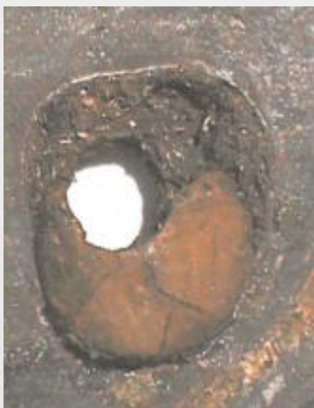
Détail d'un trou d'écoulement d'eau endommagé
